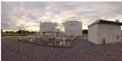
給油施設（燃料タンク 2 基）
